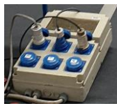
Quadro elettrico con 6 prese singole
